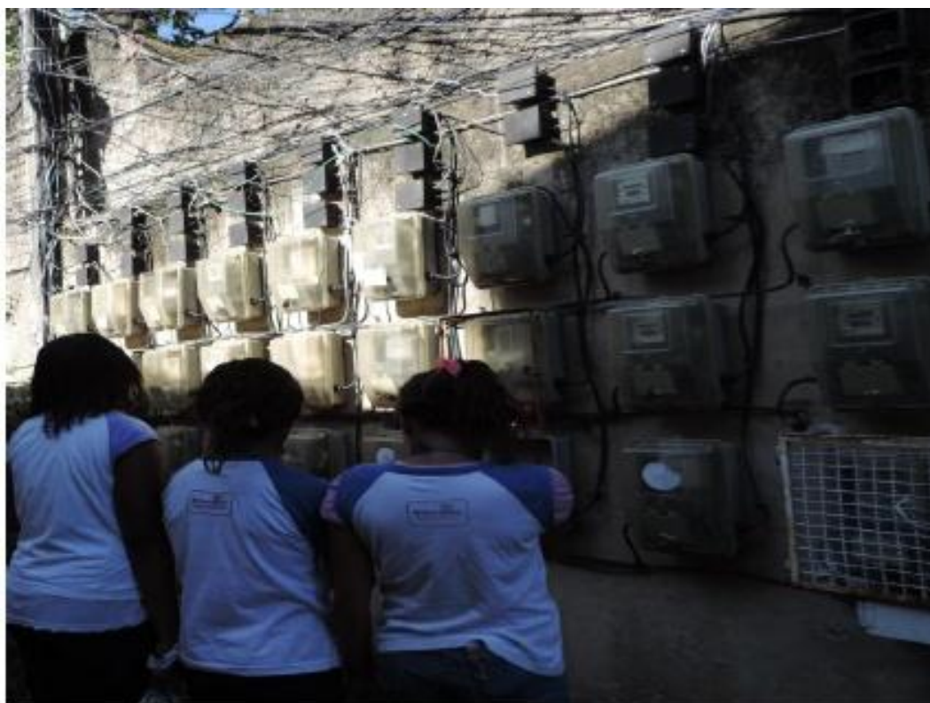
Figura 10 – Alunos Observam o quadro de energia e as fiações no início da TMA.
